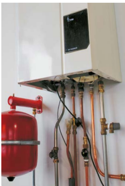
VOOR Oude ketel met koper en dunwandig staal CV-leidingwerk.
