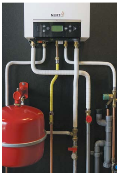
NA Nieuwe ketel met DRL PRO-FitPipe® vormvaste rvs leiding.
